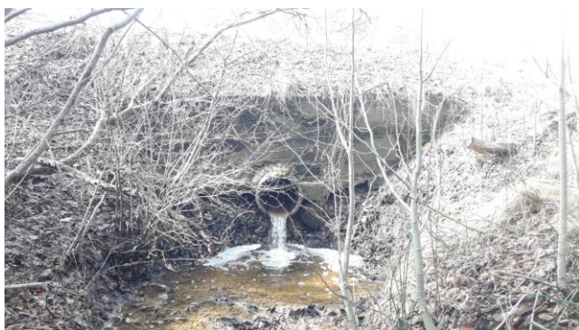
Pilt 3 – 20240327 Väike-Koru eesvoolu kraavi K-1 betoontruubi d0,45 m väljavool 11421 Laagri-Hüüru teel. Truubi betoonist portaal on vajunud kaldu ja selle alumine osa on murenenud.
